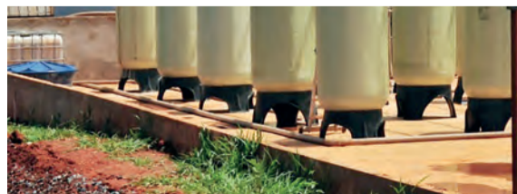
Unidade de Tratamento de Chorume
