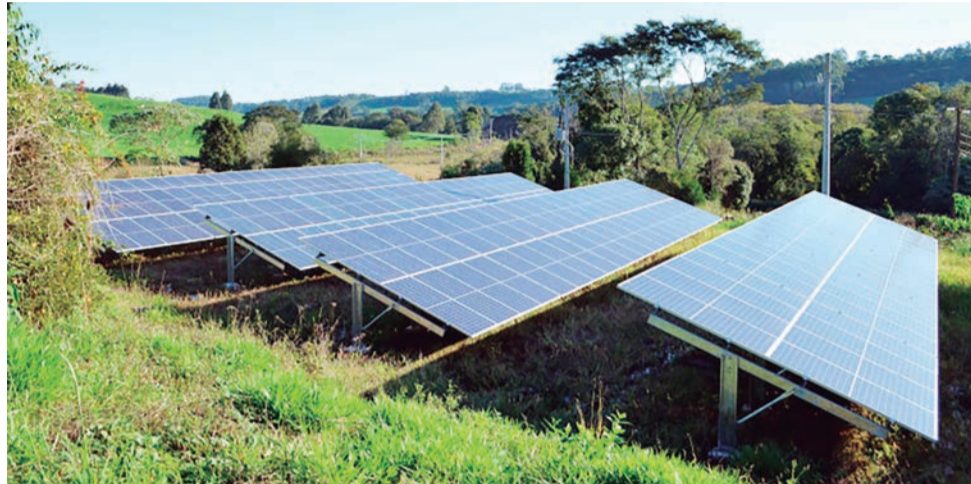
Projeto pretende que órgãos públicos estaduais sejam abastecidos com energia solar
