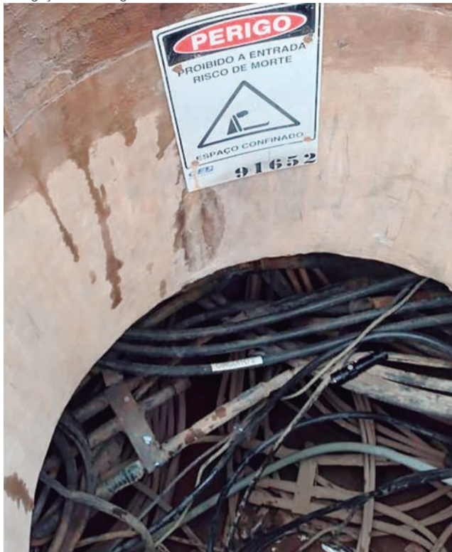
Furto de cabos em caixa subterrânea: Neoenergia começou a instalar sensores e alarmes para inibir esse crime
