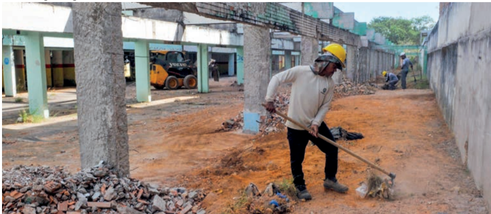
Construção da UBS 7 do Gama foi iniciada este mês; unidade incluirá Centro de Especialidade Odontológica e ambiente de acupuntura
