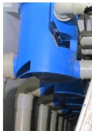
Reservatórios menores que captam a água gotejada dos aparelhos de ar-condicionado de salas comerciais
