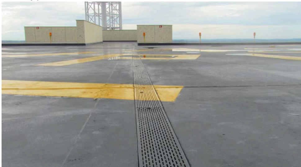
Área de captação de água das chuvas situada no heliponto de edifício situado no Setor Marista
