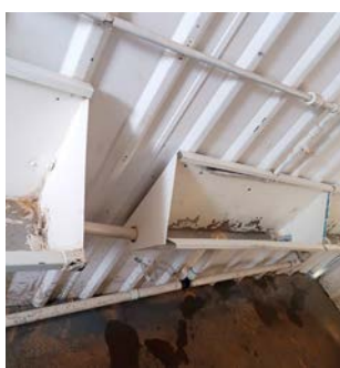
Ligação que leva água do lavagem de mãos do banheiro para o mictório
